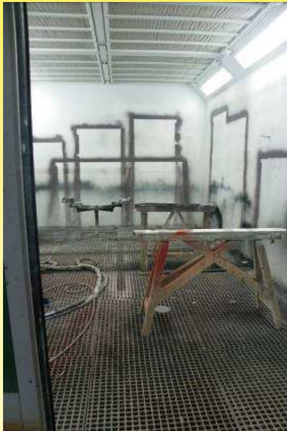
Cabine de séchage (vernis) (en surpression, filtration verticale)
